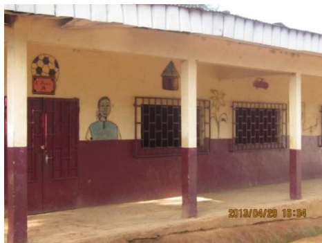
Photo 7. Bâtiment principal de l'école maternelle annexe de Sabongari L'état de la véranda fait déjà comprendre qu'il nécessite une réhabilitation Cliché ACAGER, avril 2013
